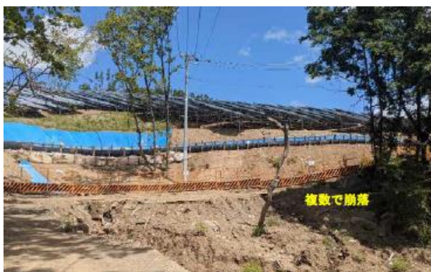
甲斐市内の防災対策が不十分な太陽光発電設備の設置状況（左：土砂崩落の発生、右：調整池が機能しないケース）
